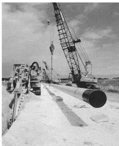
写真1 天然ガスパイプライン
