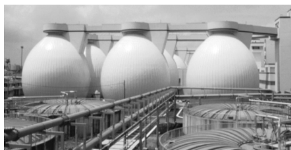
写真 6 下水污泥卵形消化システム
